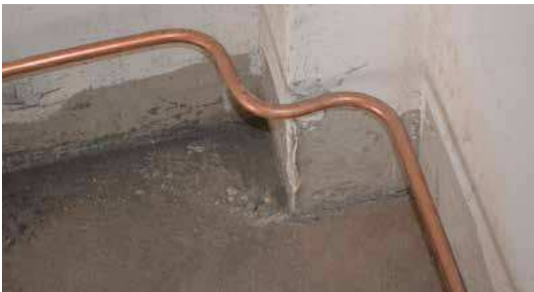
Conducteur de mise à la terre équipotentielle
