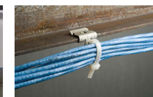
Kabel abgehängt von Trägern
