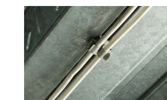
Kabel und Kabelschutzrohre abgehängt von Metalldecken
