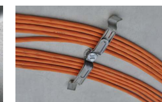
Kabel abgehängt von Decke/Wand aus Beton
