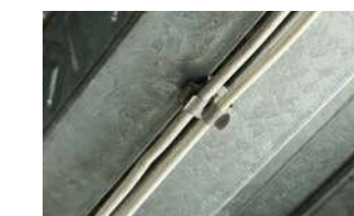
Cables & conduits from metal deck
