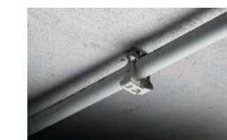
Conduit on concrete
