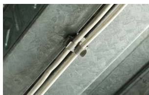
Kabel und Kabelschutzrohre abgehängt von Metalldecken
