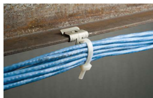
Kabel abgehängt von Trägern
