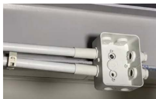
Kabelschutzrohre und Verteilerdosen abgehängt von Trägern
