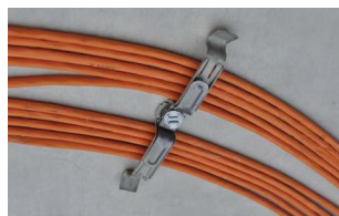
Kabel abgehängt von Decke/Wand aus Beton
