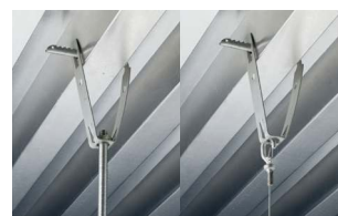
Gewindestange/Kette/Draht abgehängt von trapezförmigen Stahldecken
