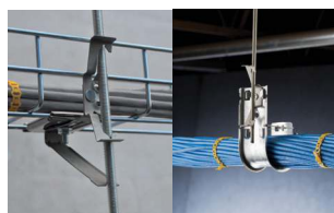
Kabel abgehängt von Gewindestangen
