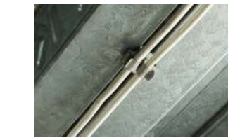
Câbles et conduits sur bac acier
