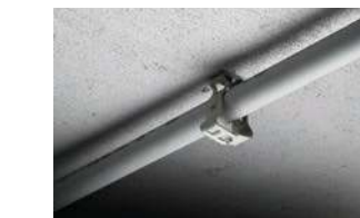
Conduit sur dalle béton
