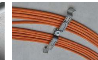
Câbles sur plafond / mur en béton
