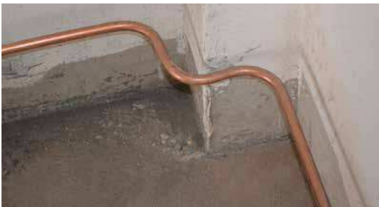
Equipotential grounding conductor
