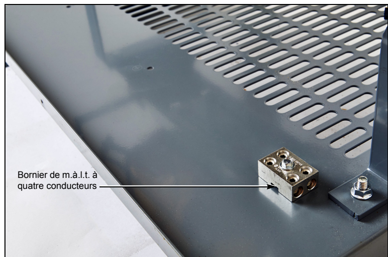
Figure 24 : Bornier de m.à.l.t. à quatre conducteurs
